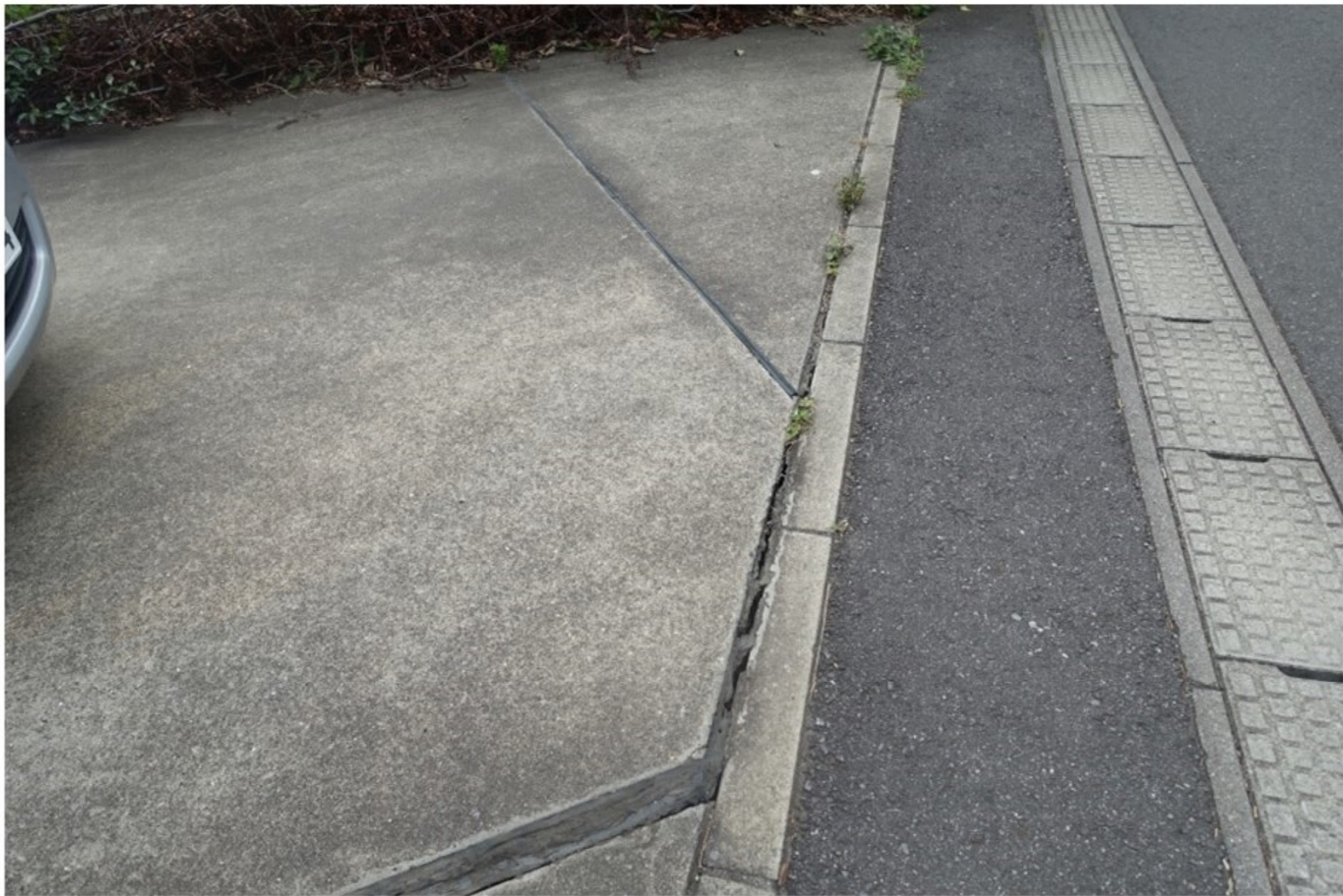
コンクリートの隙間と補修
