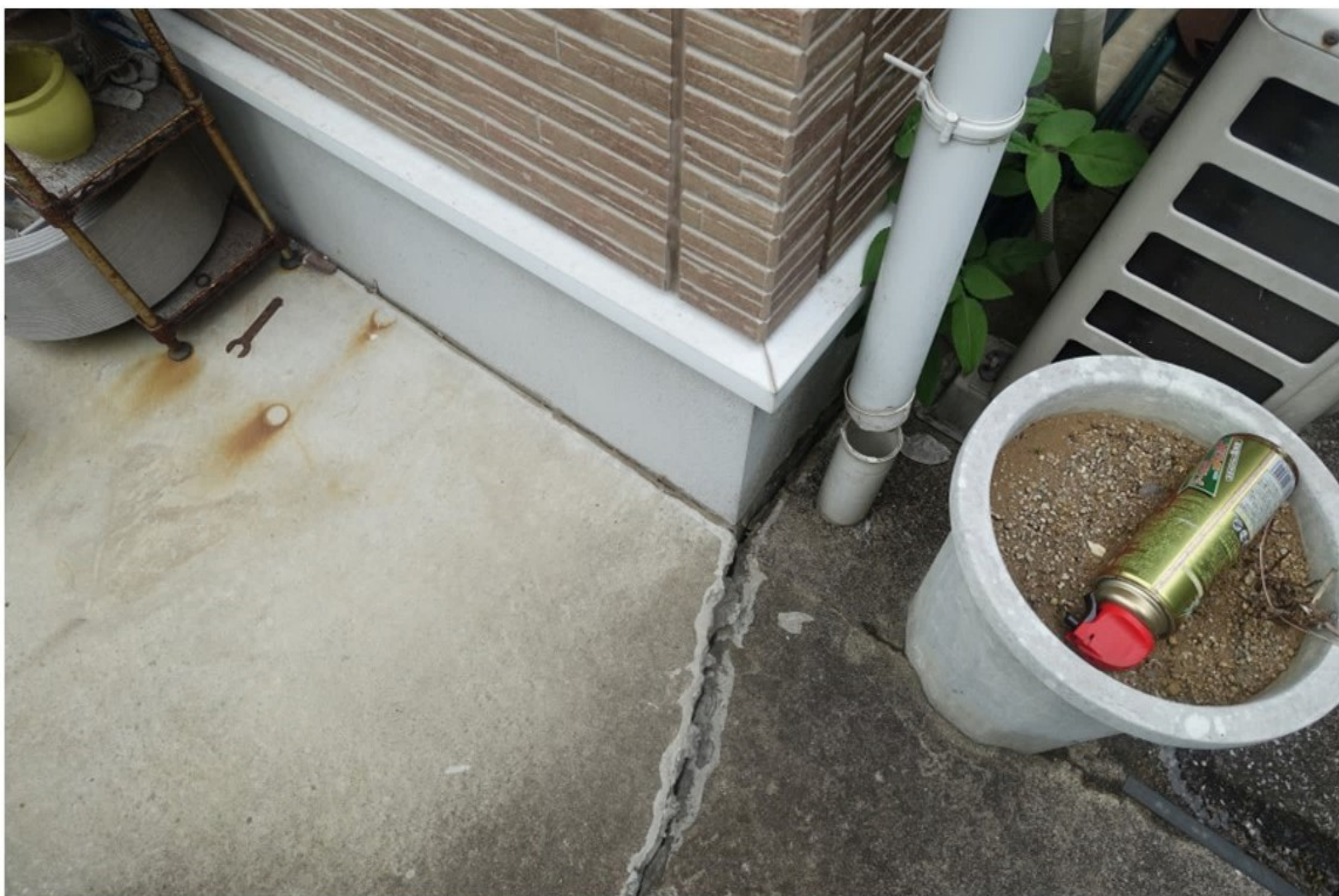
対象建物南西角の段差
