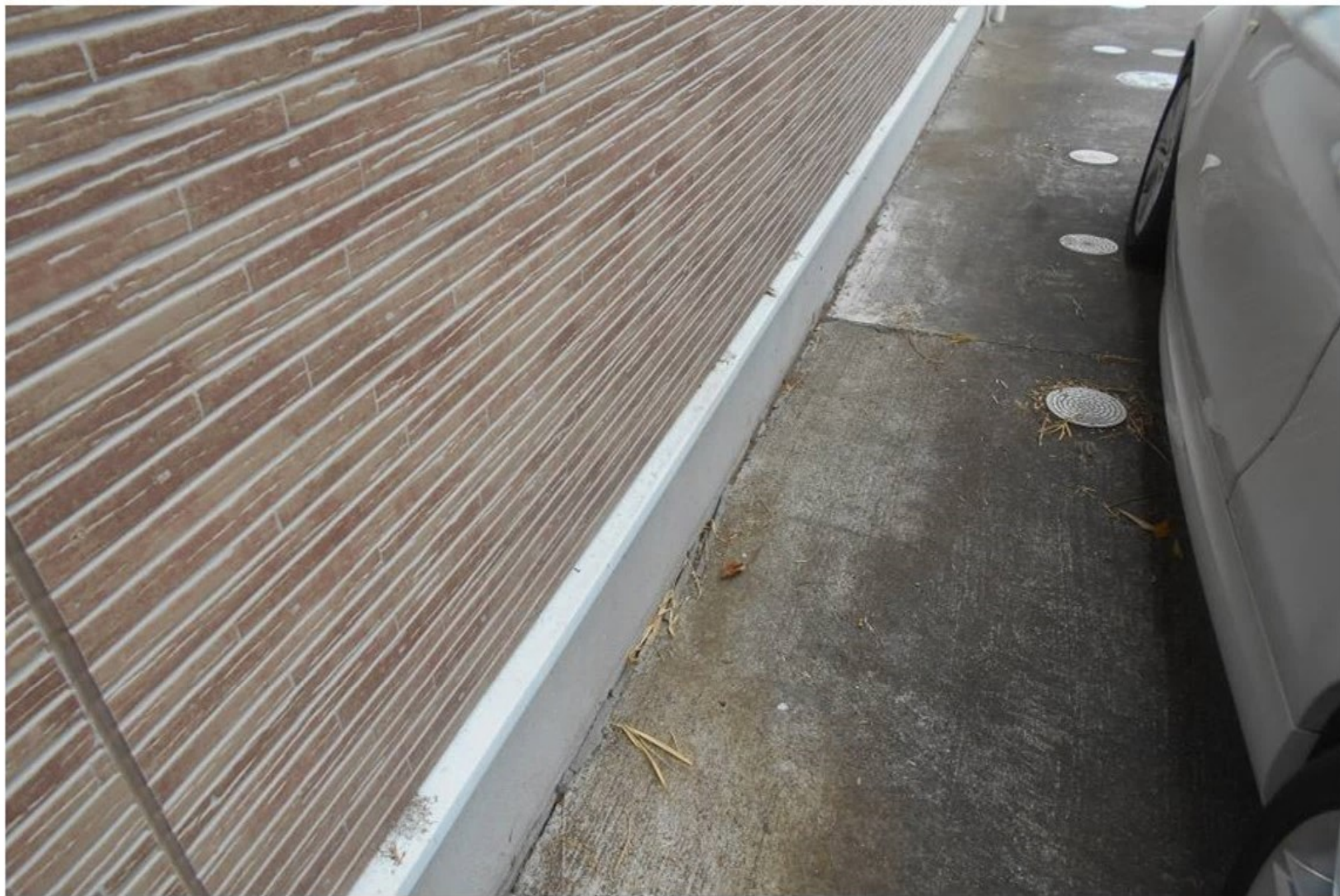
基礎と土間コンクリートの隙間
