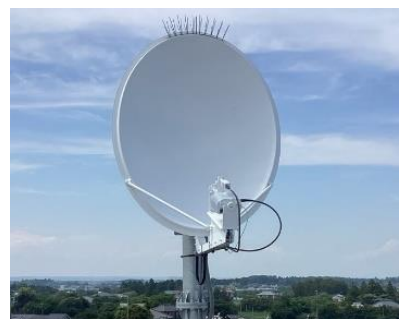
例) 衛星通信用パラボラアンテナ
