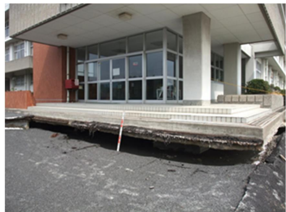
図2 地震直後の構造物の入り口付近の被害状況。
