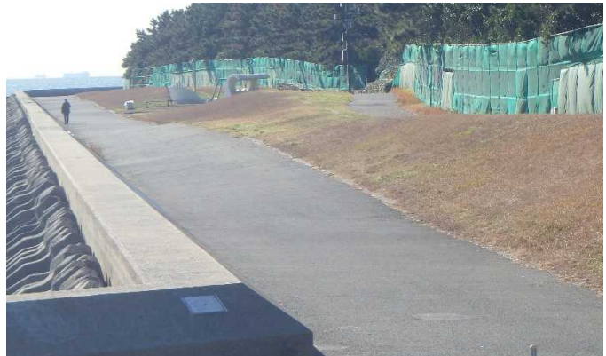
図2a 調査地の地表変形。護岸沿いの舗装道路の一部が盛り上がっている。
