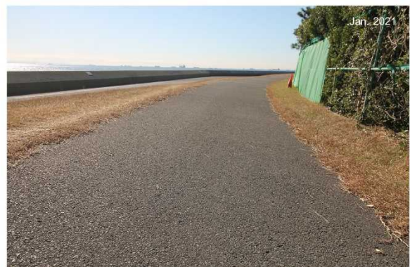
図2c 調査地の地表変形。堤体上の道路は地すべりのように法面の反対側がより多く沈下した。
