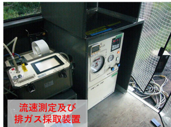
写真 2 ばい煙測定車内の主な測定機器(1)
