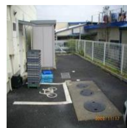
写真1 浄化槽の様子 店舗の裏や片隅に目立たないように設置されています。
