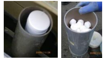
写真6 消毒筒の状況
