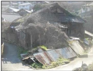
特定空家等 (老朽化が進み、倒壊等の危険性大)
