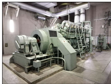
非常用自家発電設備（ディーゼル発電装置）
