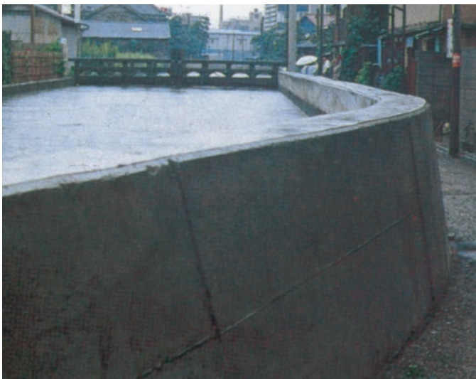
大雨のあと、海老川 えびがわ は道路 どうろ や宅地 たくち よりも水面 すいめん が高くなる (1971(昭和46)年 船橋市宮本付近 ふなばし みやもと ふきん )
