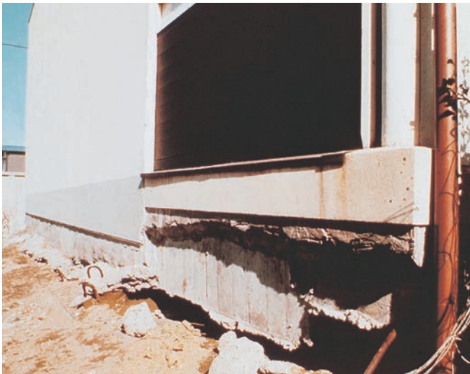
まわりの地盤 じばん が沈下 ちんか して、建物の基礎 たてものきそ があらわれた (1973(昭和48)年 浦安市 うらやす )
