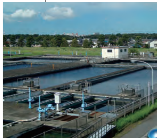
●沈でん池（柏井浄水場）
