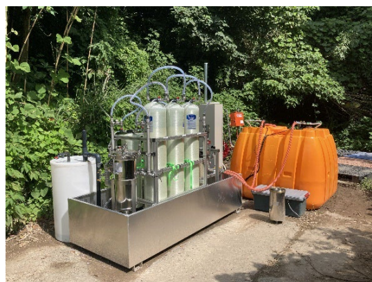
図 13 水処理試験装置（No. W2）
