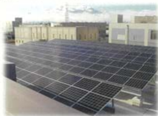
ちば野菊の里浄水場太陽光パネル
