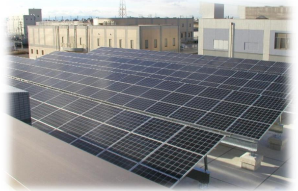
ちば野菊の里浄水場太陽光パネル
