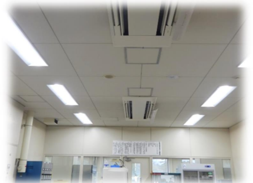
水質センターの LED 照明
