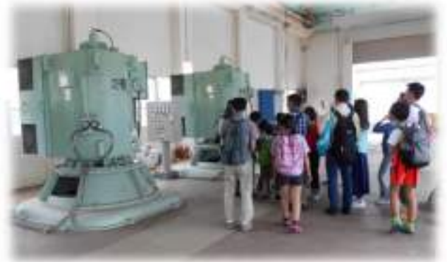
浄水場施設見学の様子（ポンプ設備）
