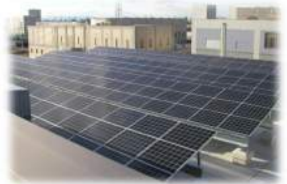
ちば野菊の里浄水場太陽光パネル
