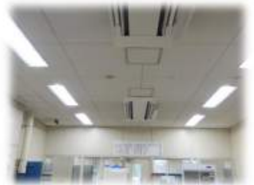
水質センターの LED 照明
