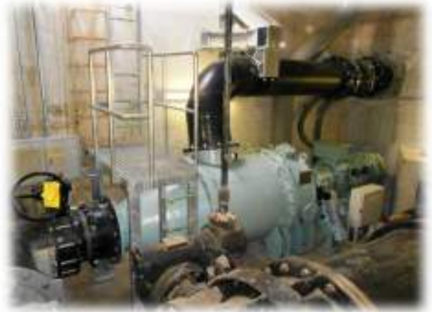
北船橋給水場の1号機マイクロ水力発電装置
