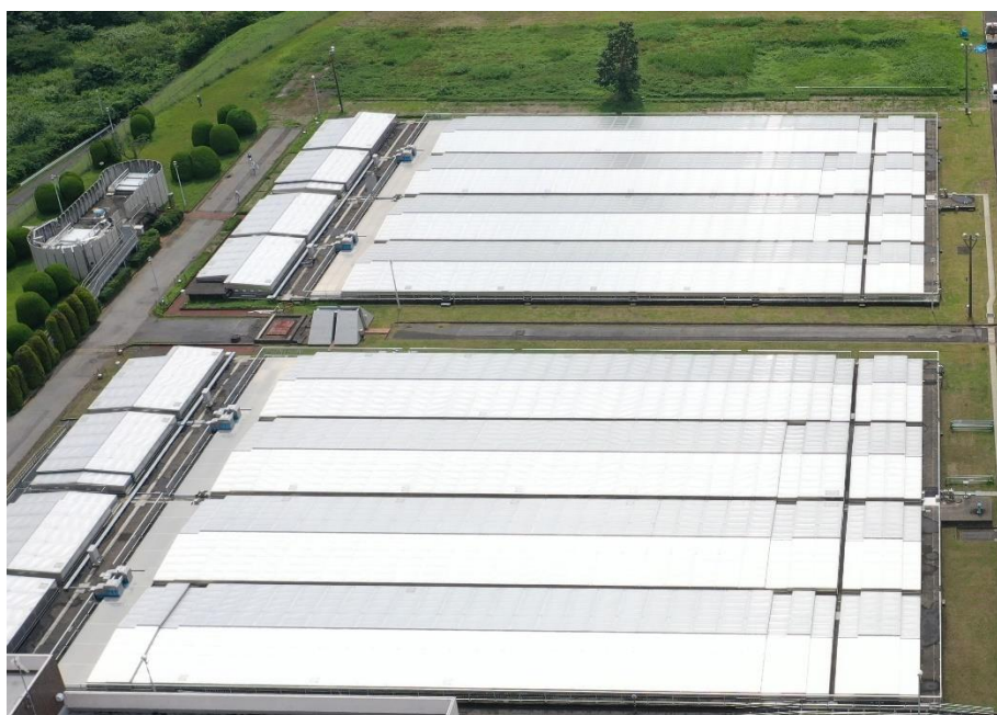
図3-7 浄水場の覆蓋化
