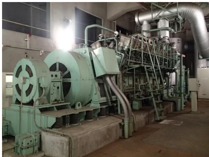
図5-3 非常用自家発電設備
