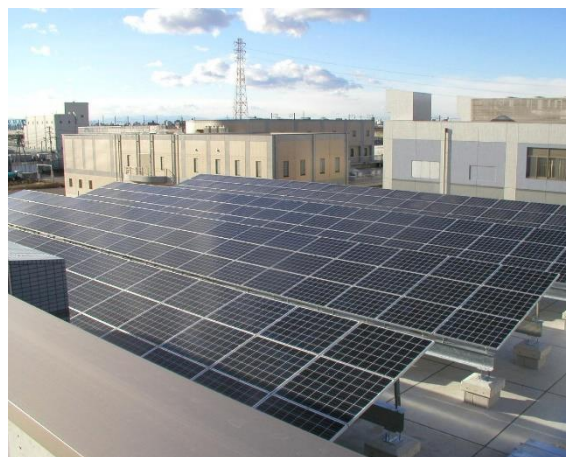
図5-17 太陽光発電設備（ちば野菊の里浄水場）
