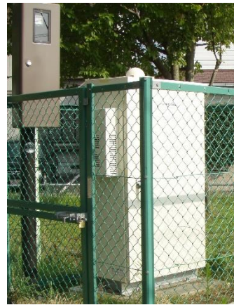
図5-10 水質自動監視装置
