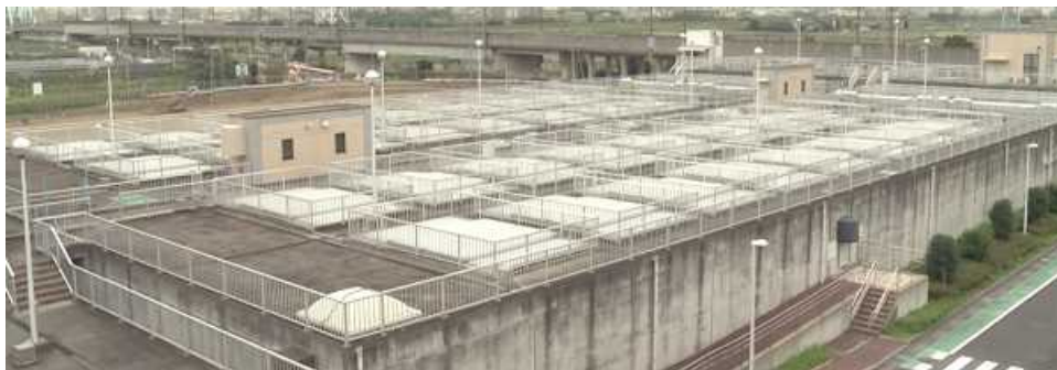
図 3-9 ちば野菊の里浄水場沈でん池に設置している覆蓋
