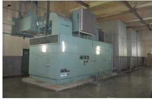
図3-3 自家用発電設備
