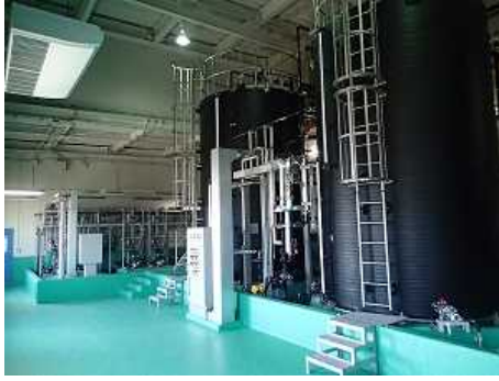
図3-2 次亜塩素酸ナトリウム注入設備
