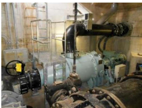
マイクロ水力発電設備
