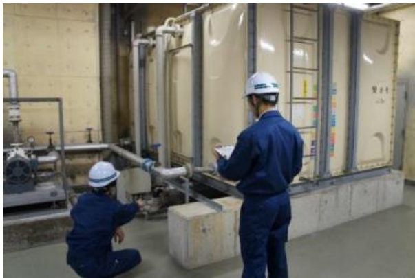
貯水槽水道地域巡回サービス
