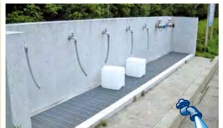
応急給水設備(ちば野菊の里浄水場)
