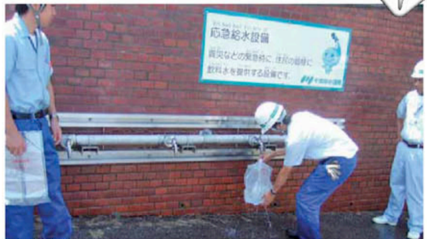
応急給水設備(柏井浄水場)
