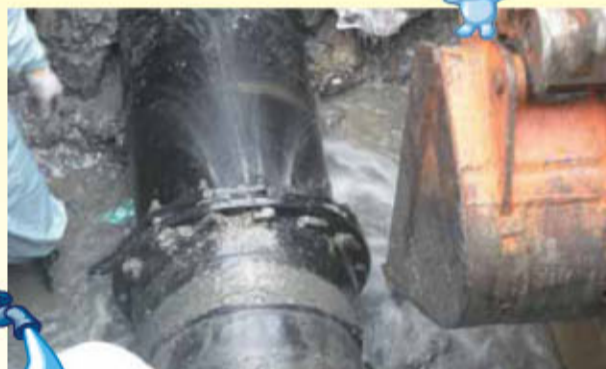
▲漏水により水が噴き出す水道管
