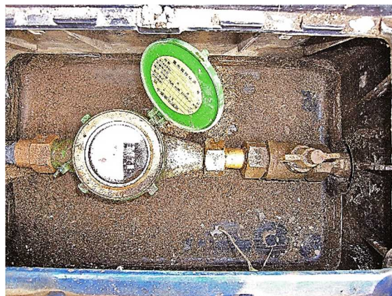
水道メーター
