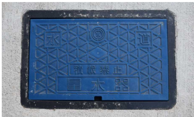
水道メーターボックス
