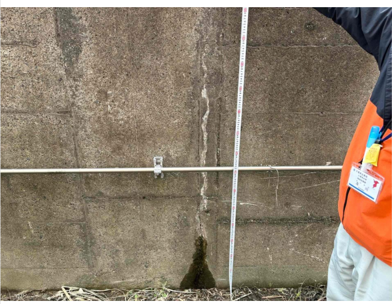
No.6 ひび割れ L = 1.5m エフロレッセンスあり 漏水あり
