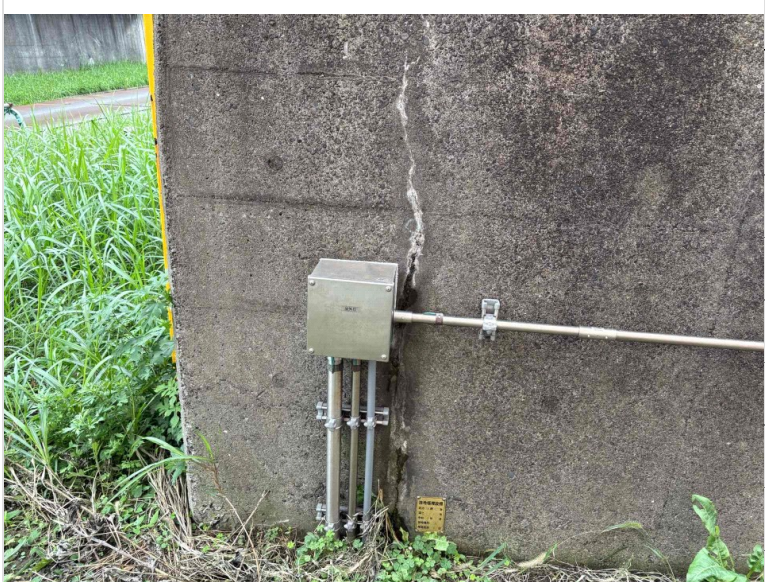
No.4 ひび割れ L = 1.8m エフロレッセンスあり 漏水あり
