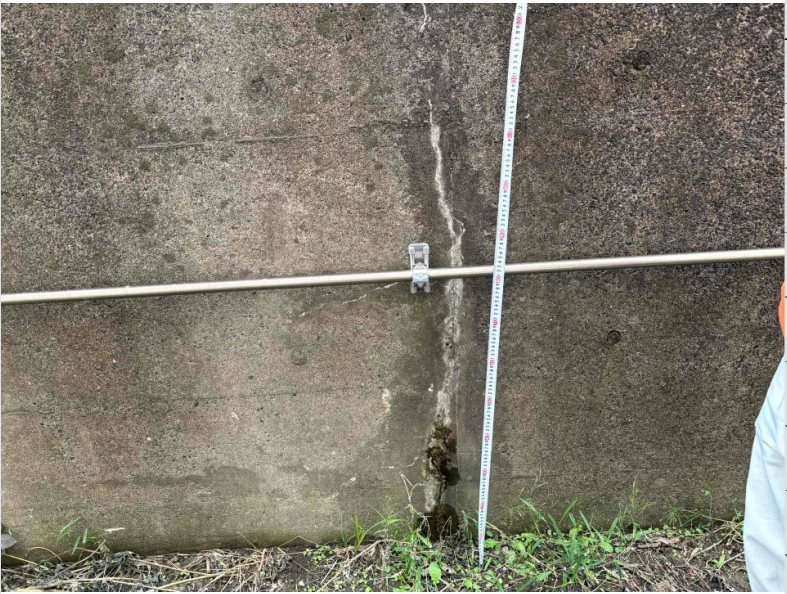
No.5 ひび割れ L = 1.4m エフロレッセンスあり 漏水あり
