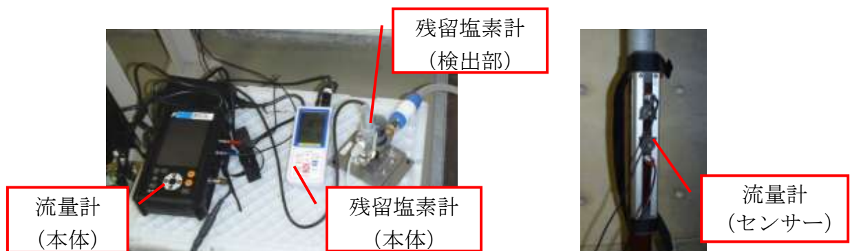
写真 3.1.3 残留塩素計及び流量計
