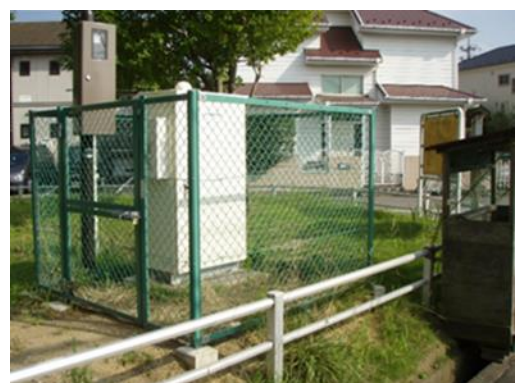
水質自動監視装置
