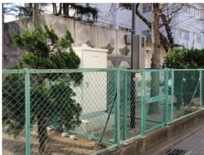
図 1-1-1 水質自動監視装置の外観
