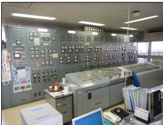
図8 監視設備（更新前）
