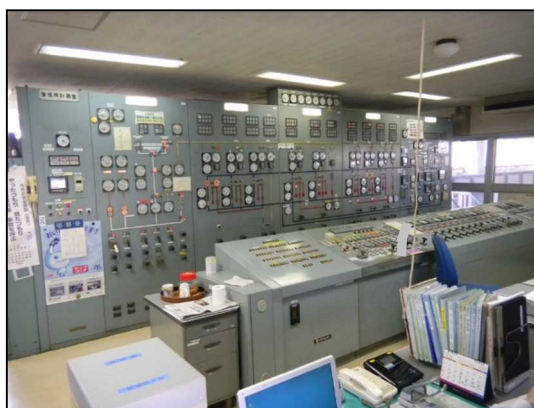
図8 監視設備（更新前）
