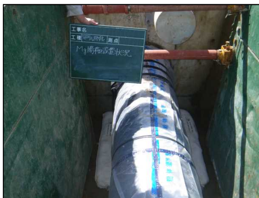
図 1 6 電気防食設置状況
