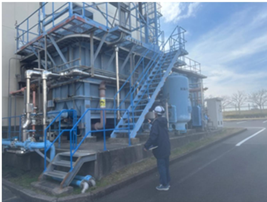
写真 6 ろ過濃縮装置（外観）確認（設備稼働状況確認）
