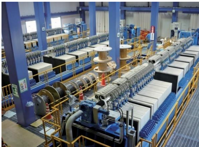
写真 2 本事業により整備した脱水設備
