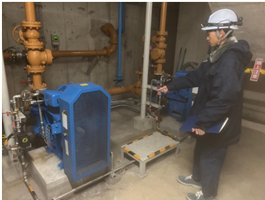
写真 5 濃縮槽引抜ポンプ確認（設備稼働状況確認）
