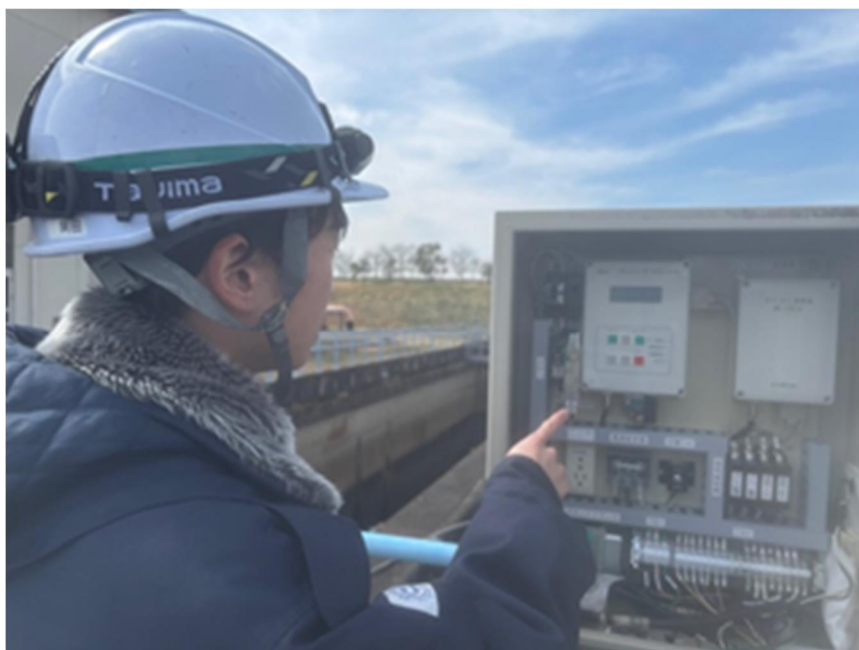
写真 8 上澄水返送濁度計現場盤の確認 （設備稼働状況確認）
