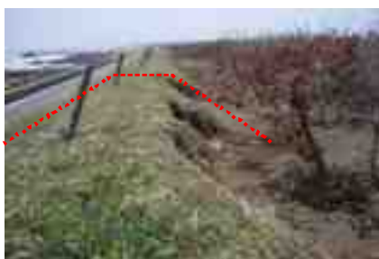
土塁の裏法損傷（旭市三川）
