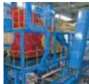
金属破碎・選別設備
