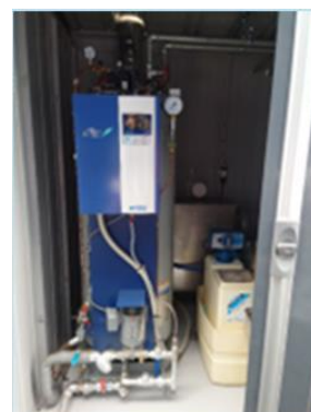
蒸気ボイラー
