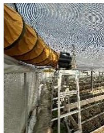
外気導入 ダクトファン
