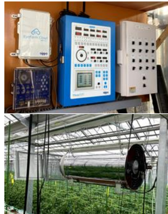
(上) 温室内の環境制御を行う「統合環境制御装置」 (下) 温室内への炭酸ガスの供給を行う「炭酸ガス施用機」
