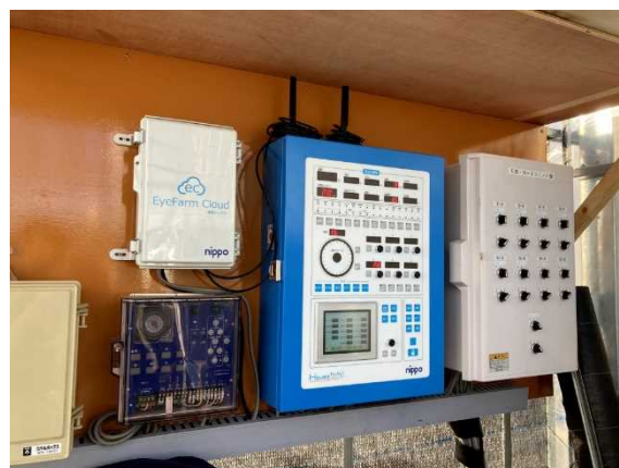
統合環境制御装置（換気、灌水などを制御）
