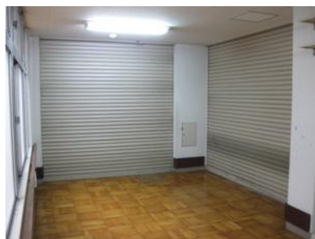
(写真17：防火シャッターを下ろした様子)
