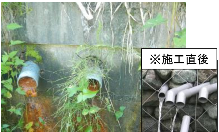
横ボーリング工の目詰まり
