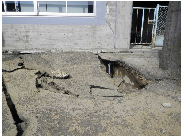
船橋排水機場 舗装の陥没
