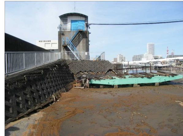
海老川水門 取付護岸の破壊
