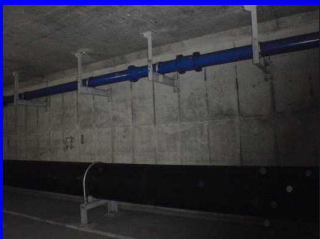
共同溝内部(再生水送水管は上部の管)
