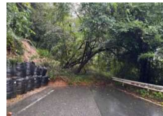
土砂崩れ、道路の寸断
