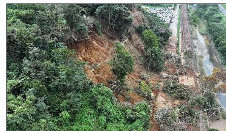
道路・鉄道と沿道斜面の被災
