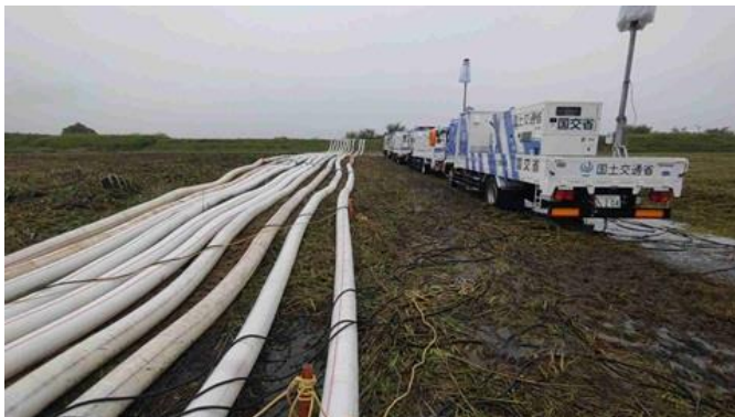
大竹機場におけるポンプ車排水(2)_配置状況 (30日1時25分稼働開始)
