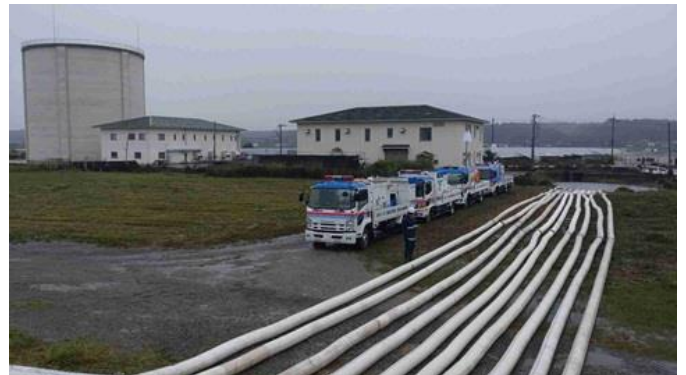
大竹機場におけるポンプ車排水(1)_配置状況 (30日1時25分稼働開始)
