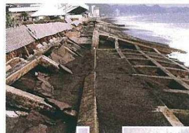
東条・広場東海岸 (鴨川シーワールド前・平成9年の被害)
