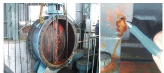
劣化した部品の例
