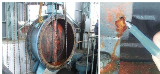
劣化した部品の例
