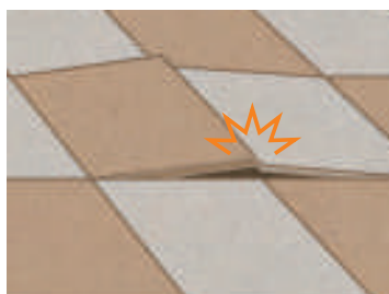
床タイルの浮き
