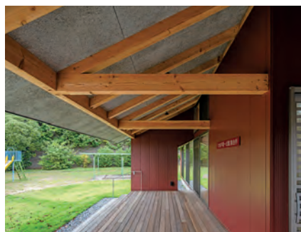
水平材と斜材で組んだ片持ち梁により、小断面材で間口8100mmの屋根を支持する (撮影:東涌宏和)
