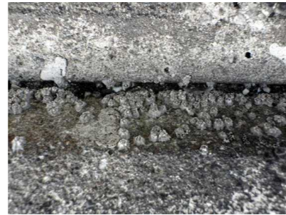
被覆ブロックの目地に着生するイワフジツボ
