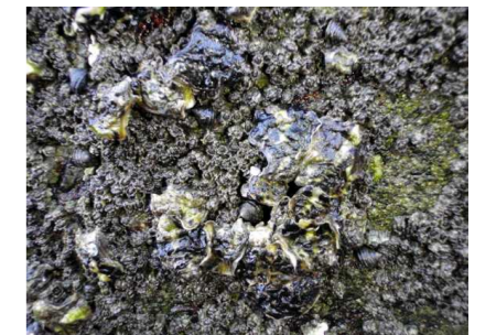
階段護岸の壁面に着生するマガキ(中潮帯)
