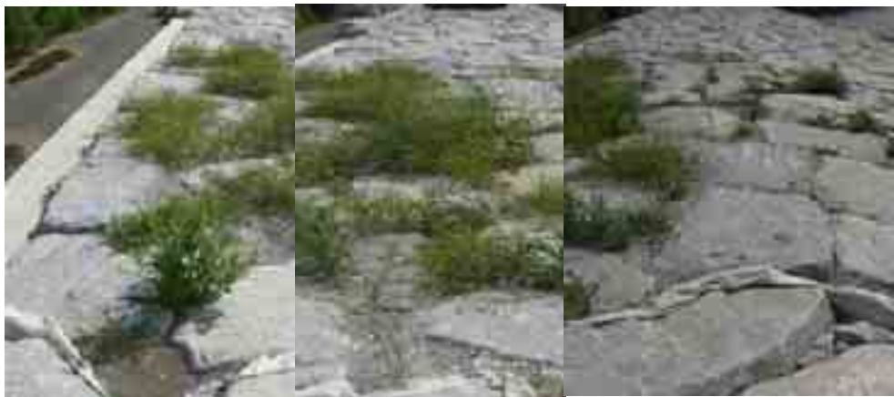
海砂ゾーン（右が海側）第6回モニタリング調査時
