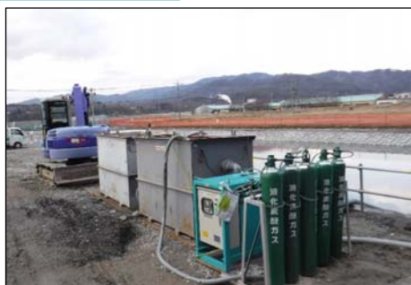
アルカリ排水中和処理設備の例
