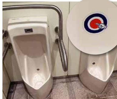
的シールの貼ってある小便器
